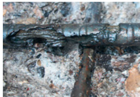
Ausgeprägte Lochfrasskorrosion der 4. Bewehrungslage.
