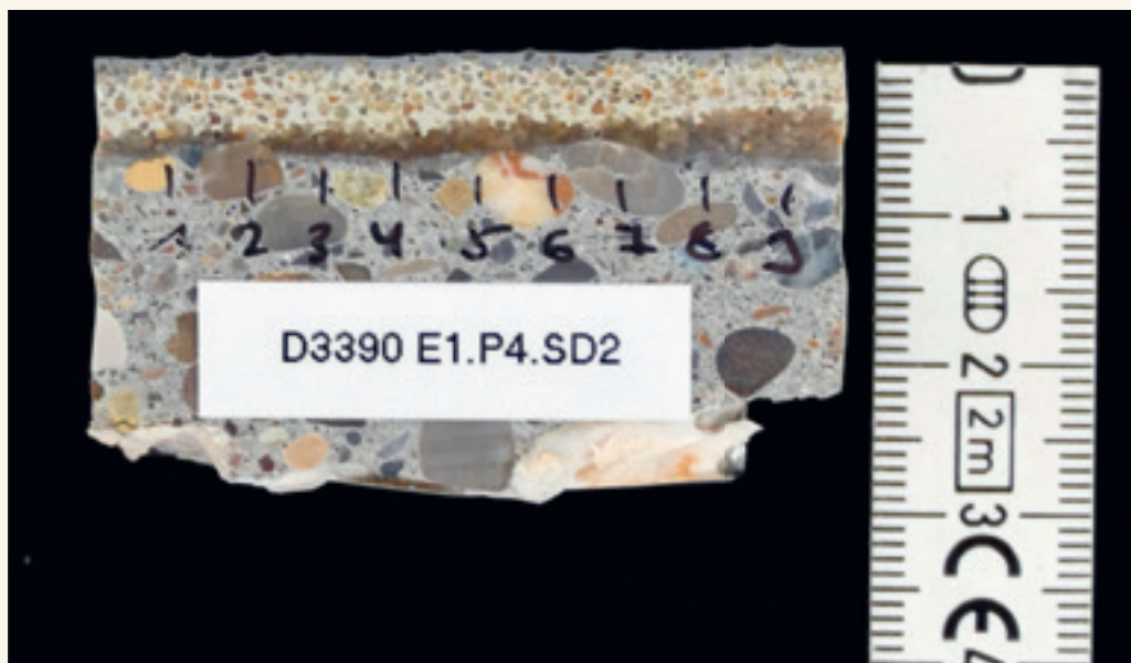
Schichtdicke des Parkdecksystems am Anschliff bestimmt.
